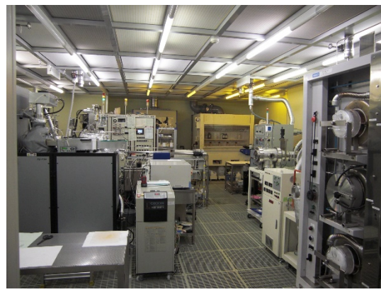
フロンティア研究棟(S2棟)クリーン室・共通実験室 300 m 2
